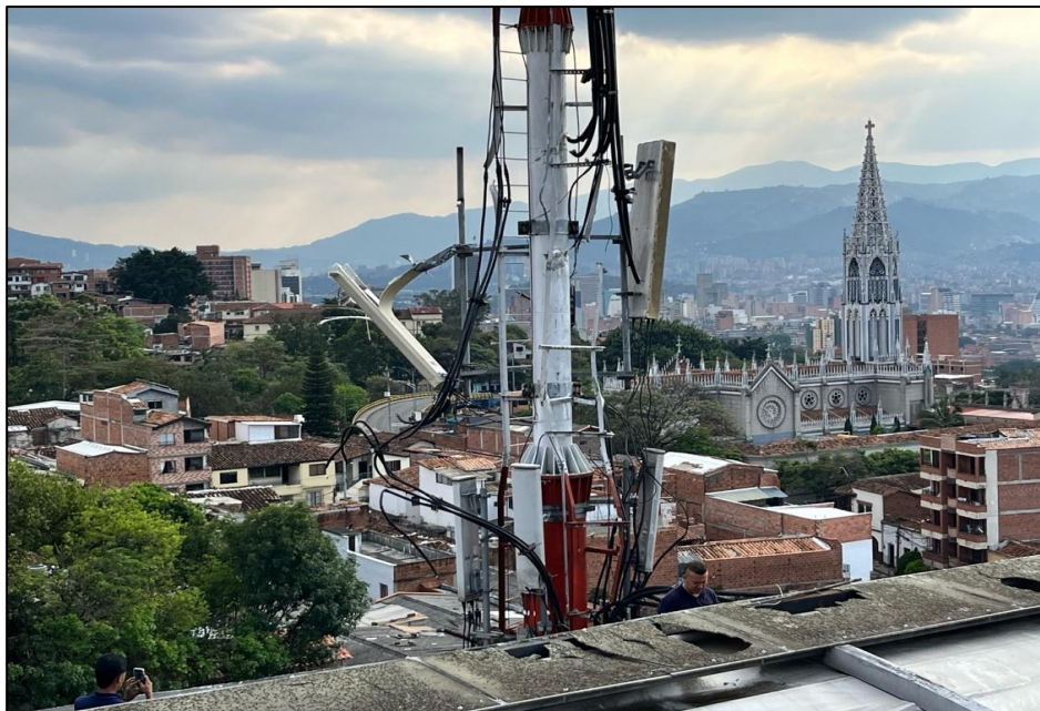
Fotografía No. 5 – Detalle de daños generales en la antena de celda celular de comunicación.
