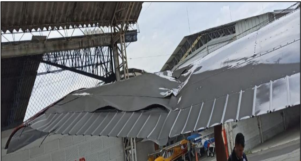
Fotografía 2. Deformación en la piel superior, entre las estaciones 144 a 208. Se presentó ondulación, hundimiento y separación de la piel en la parte superior del plano izquierdo, entre las estaciones mencionadas.
