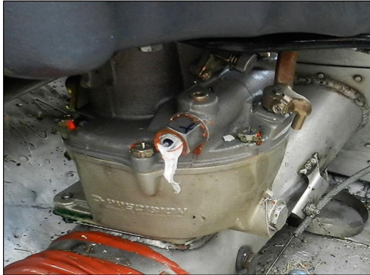
Fotografía No. 7: Evidencia del carburador/ cinta -teflón y de la desconexión de la manguera de combustible
