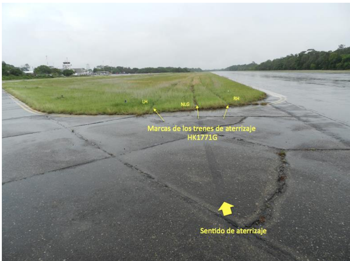
Marcas de los trenes de aterrizaje durante la excursión de pista a la altura de calle de rodaje A
