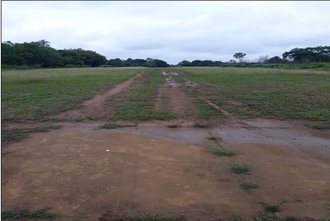
Fotografía No. 2: límite de la capa de concreto en la pista e inicio de la grama que probablemente generó el hidroplaneo.
