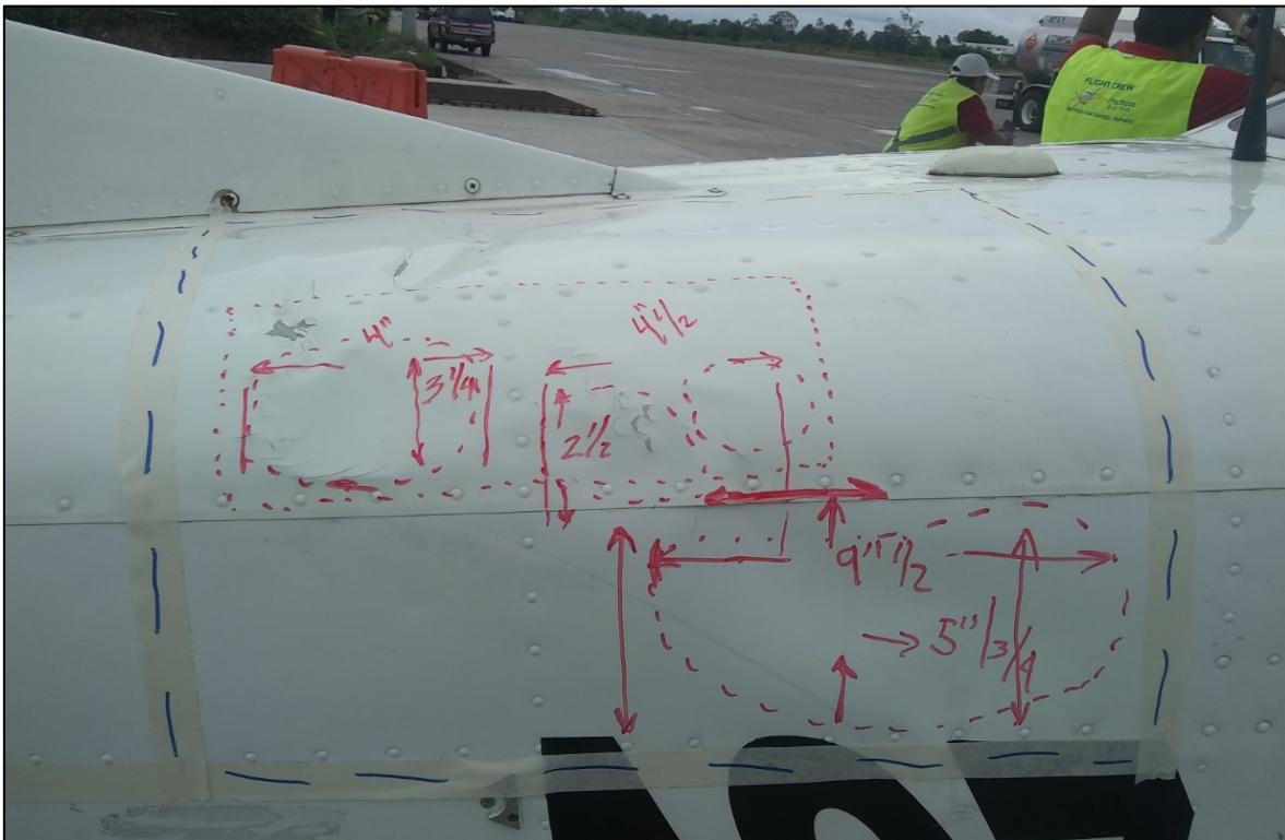
Fotografía No. 2 – Daños en piel y larguerillos de la aeronave zona derecha.
