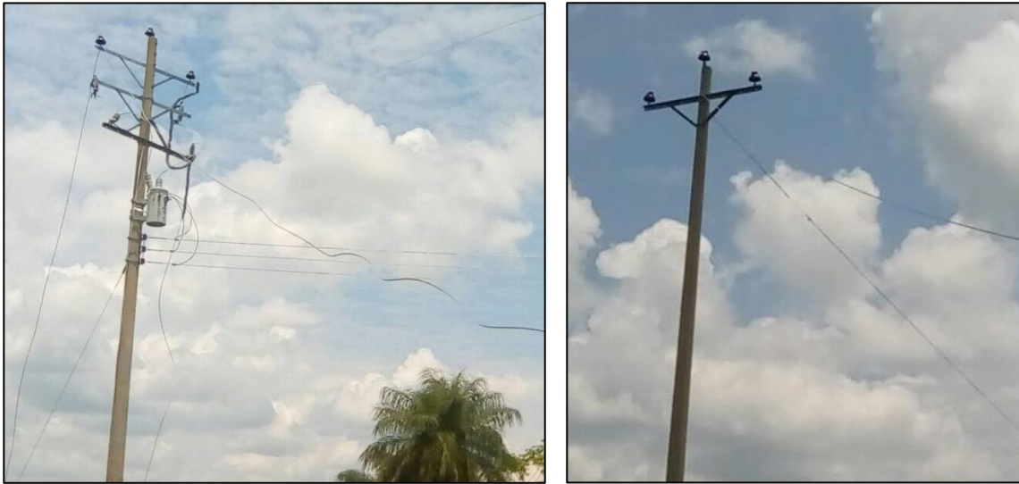
Fotografía No. 2 – Afectación al tendido eléctrico
