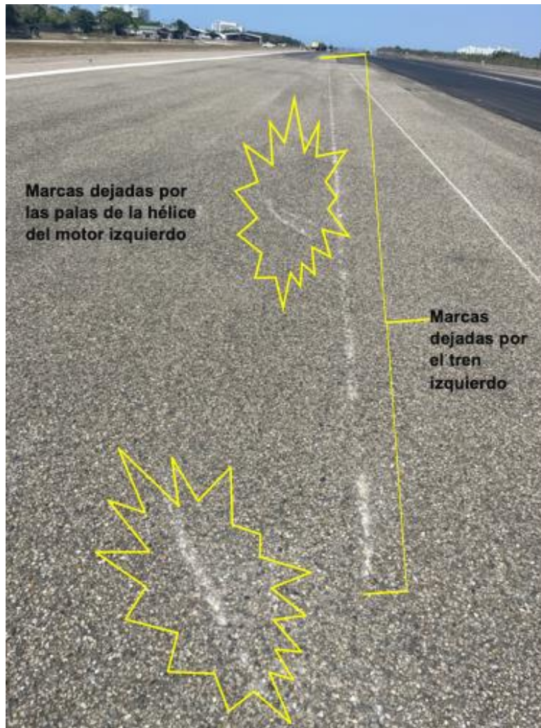
Fotografía No. 3 – Marcas de golpes de las palas y del rozamiento del tren izquierdo sobre la pista.
