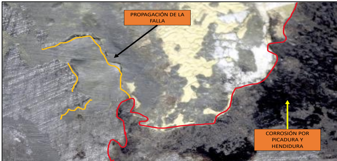
Fotografía No. 8. Vista superior zona de pérdida de pintura y existencia de residuos negros. (6.3X)
