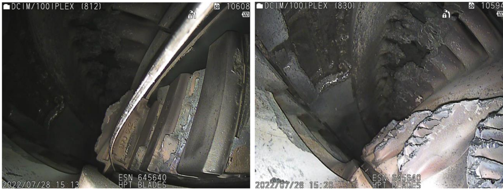
Fotografías No. 1 y 2: Estado general de la etapa de turbina de alta presión HPT, motor No. 2.
