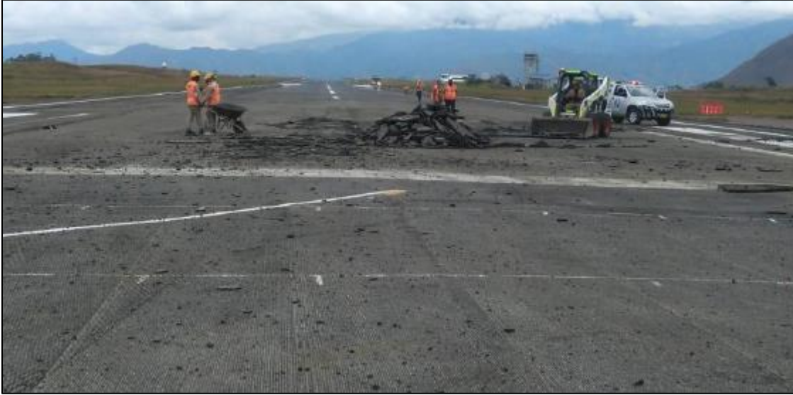
Fotografía No. 11: Estado cabecera 02 SKPS posterior al despegue del N740AV 04/10/2020
