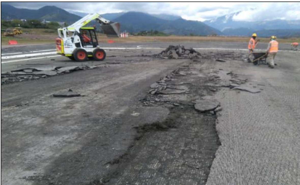
Fotografía No. 10: Estado cabecera 02 SKPS posterior al despegue del N740AV 04/10/2020
