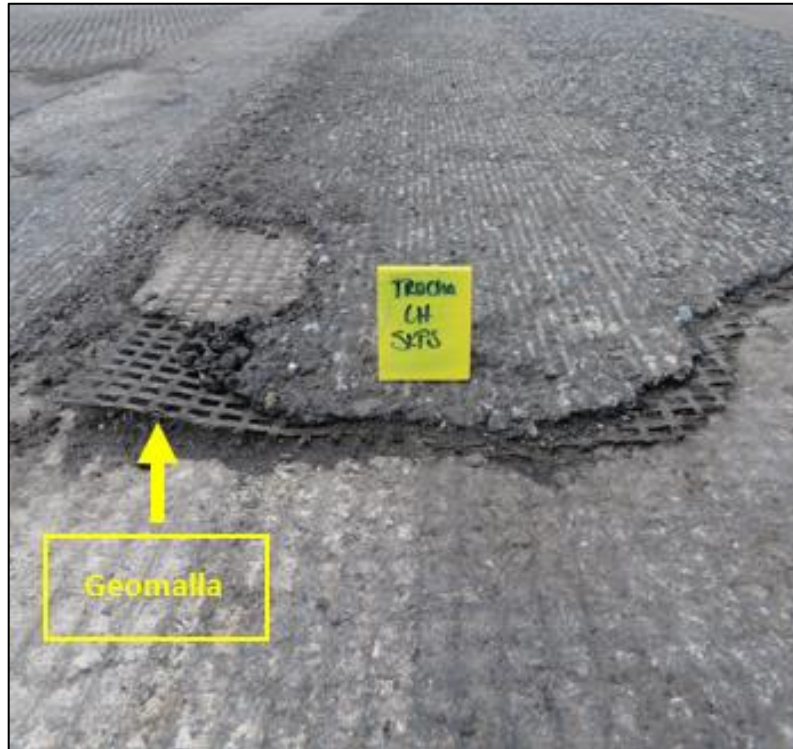
Fotografía No. 7: Falla de adherencia asfáltica Trocha LH SKPS
