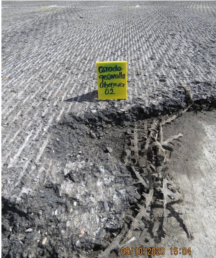
Fotografía No. 4: Estado geomalla y superficie asfáltica cabecera 02
