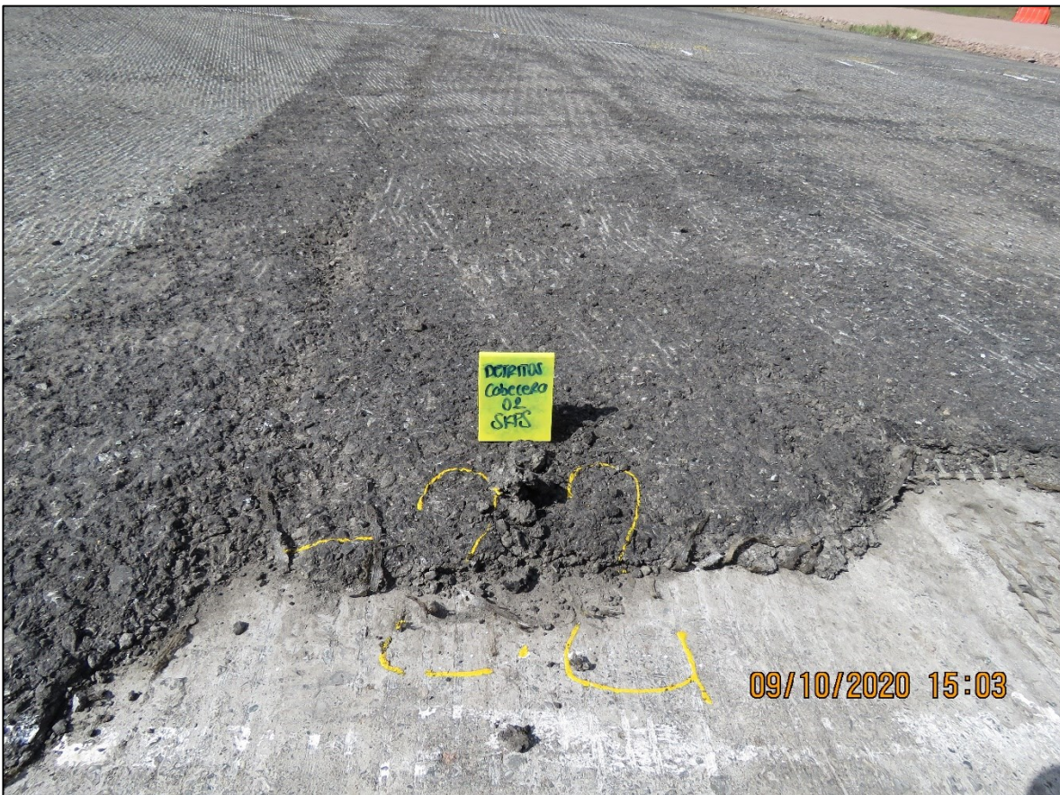
Fotografía No. 3: Estado superficie asfáltica cabecera 02 Aeropuerto Antonio Nariño
