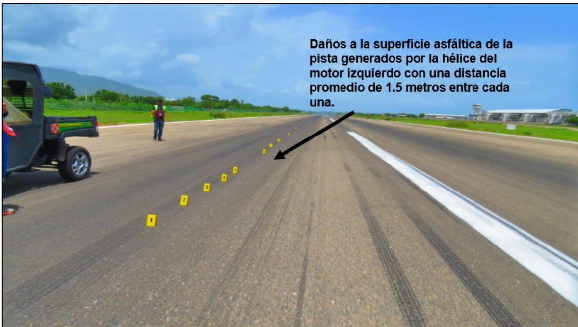
Fotografía No. 1 - Marcas en la pista dejadas por la hélice.
