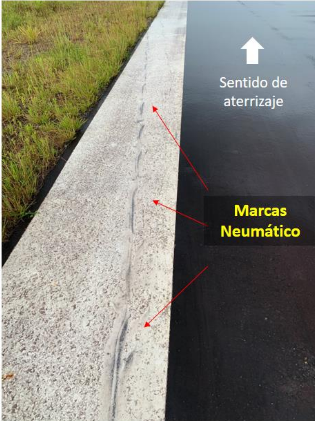
Fotografía No. 1 - Evidencias en pista de marcas del neumático del tren izquierdo HK2006
