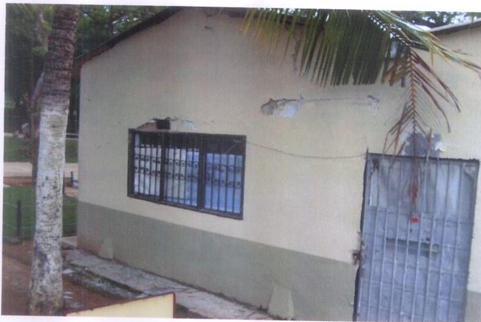
Foto 1.5 Daño causado a una instalación por acción de u trozo de pala del rotor principal del B-222U
