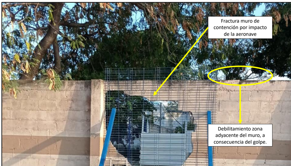
Fotografía No. 8: Daños ocasionados al muro perimetral del aeródromo.
