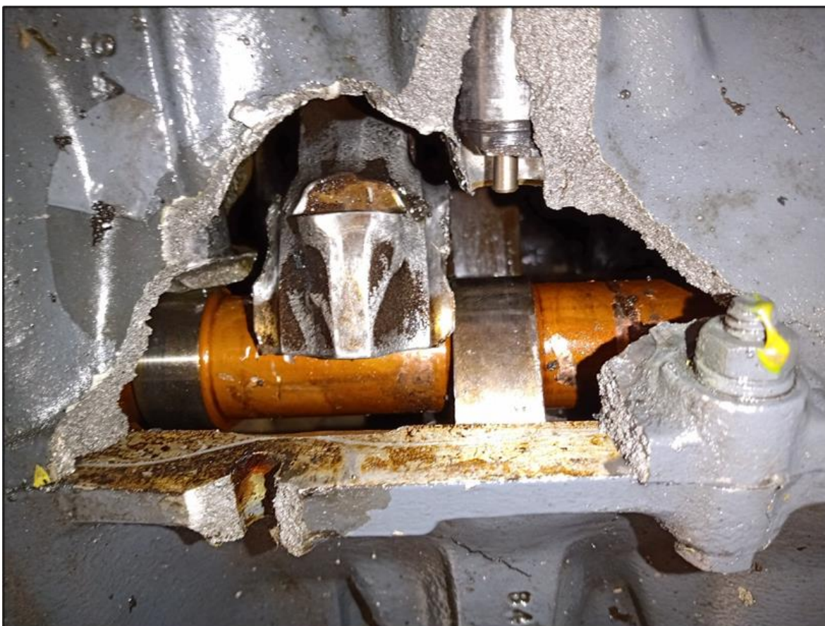
Fotografía No. 4: Rotura de cárter de potencia, parte superior.
